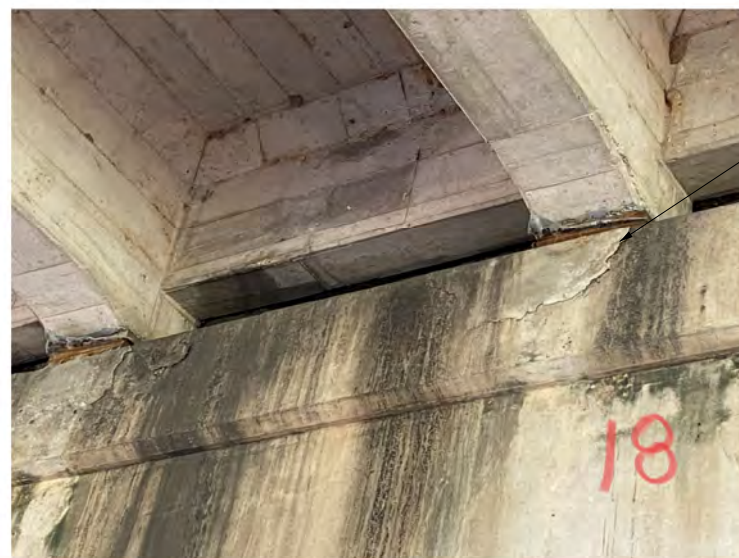
BENT CAP 5 DELAMINATION
