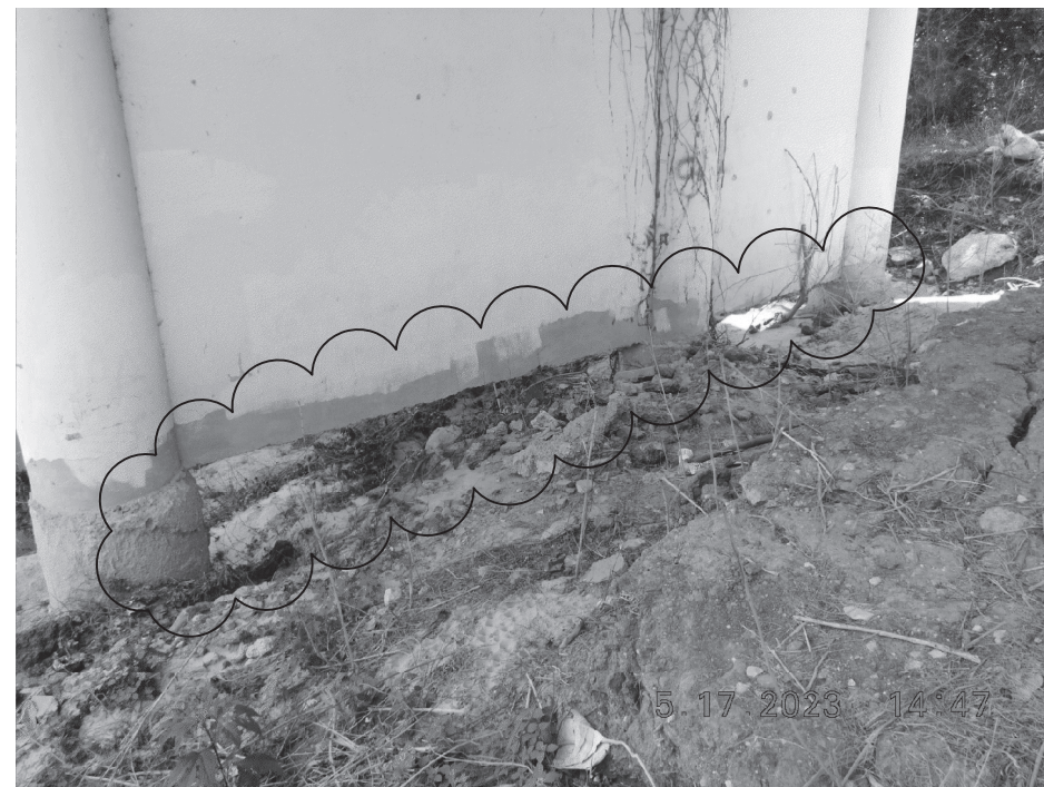
M-1,_PIC-11 @ BENT16 DS SCOUR DS~5FT,
