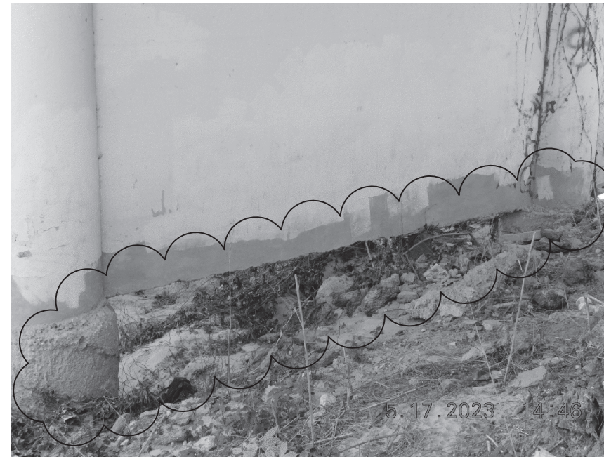
M-2,_PIC-10 @ BENT17 DS SCOUR DS~5FT
