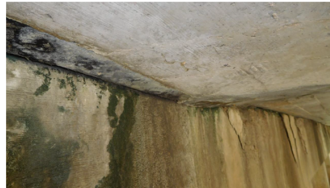
10 - Uneven slab soffit
