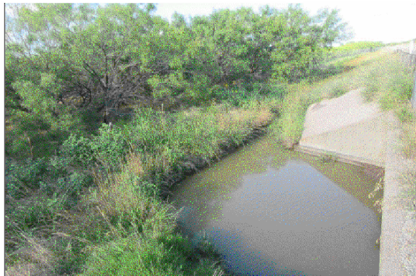
SCOUR Looking E IMG. 236
