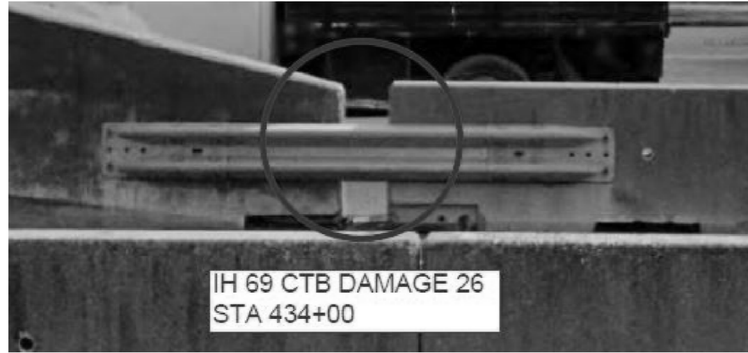
IH 69 CTB DAMAGES STA 434+00
