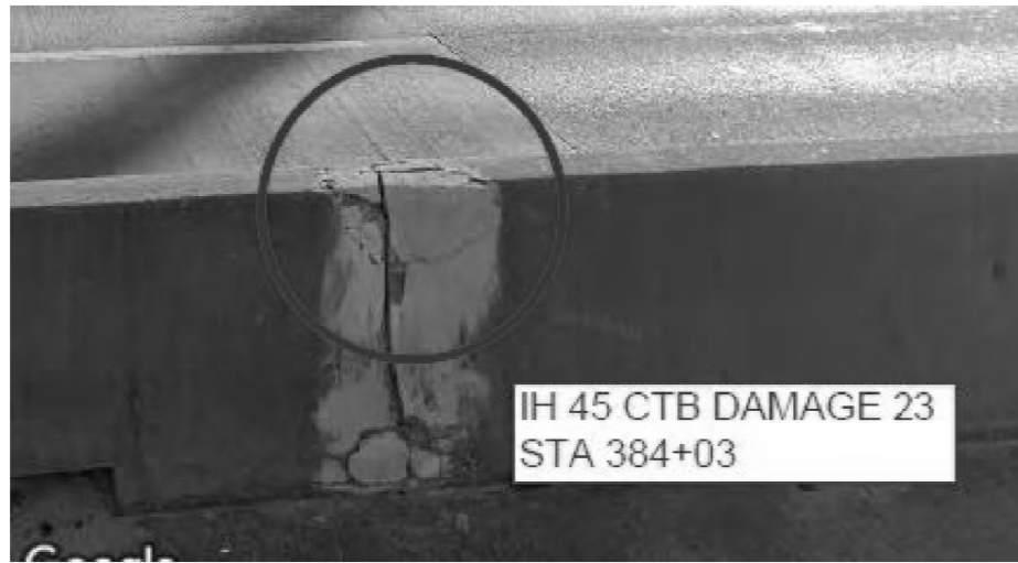
IH 45 CTB DAMAGES STA 384+03
