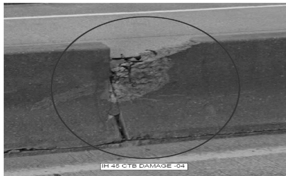
IH 45 CTB DAMAGES STA 341+79
