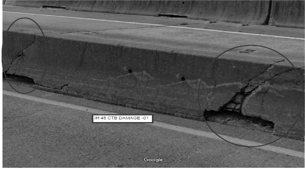
IH 45 CTB DAMAGES STA 360+58
