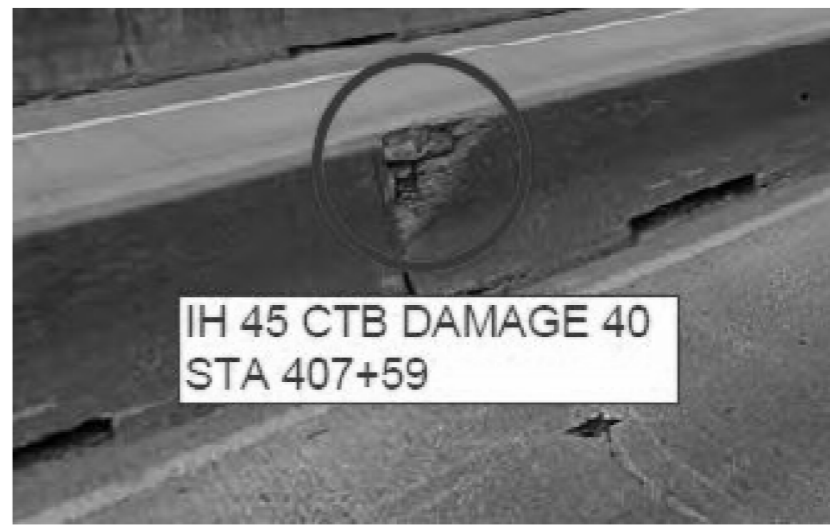
IH 45 CTB DAMAGES STA 407+59
