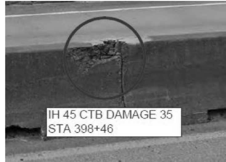
IH 45 CTB DAMAGES STA 398+46
