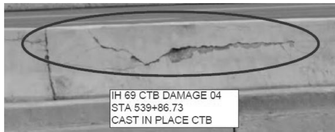
IH 69 CTB DAMAGES STA 539+86.73
