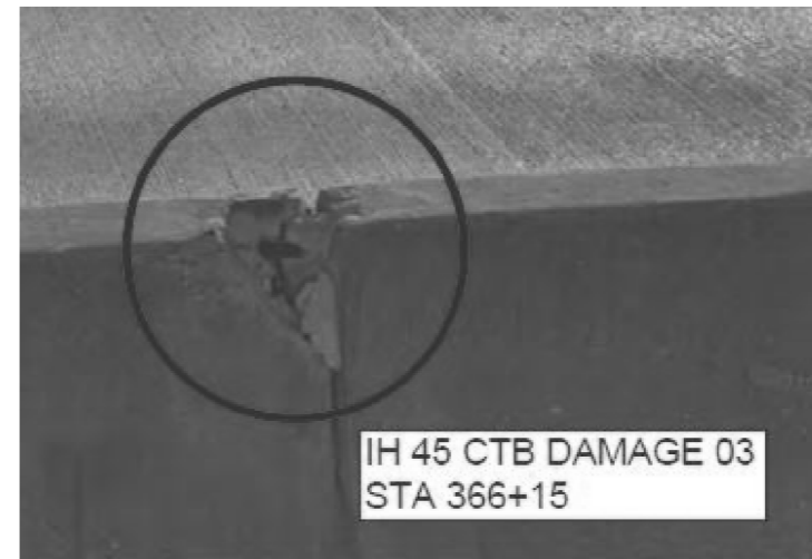
IH 45 CTB DAMAGES STA 366+15
