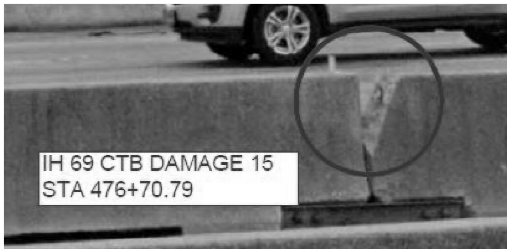
IH 69 CTB DAMAGES STA 476+70.79
