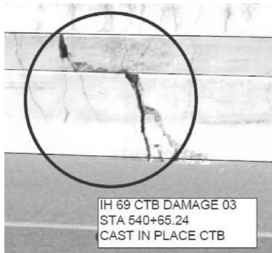
IH 69 CTB DAMAGES STA 540+65.24
