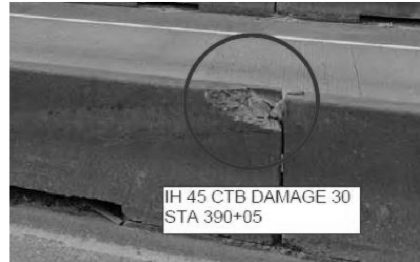
IH 45 CTB DAMAGES STA 390+05
