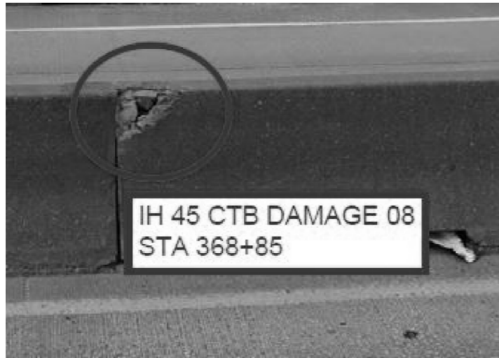
IH 45 CTB DAMAGES STA 368+85
