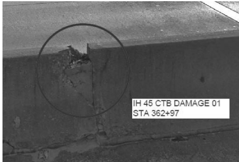
IH 45 CTB DAMAGES STA 362+97
