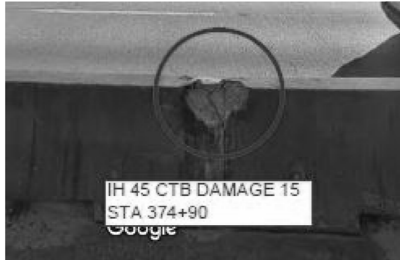
IH 45 CTB DAMAGES STA 374+90
