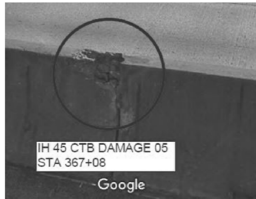
IH 45 CTB DAMAGES STA 367+08
