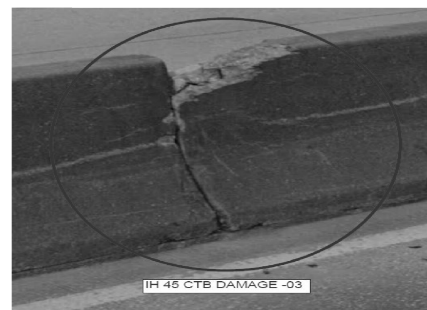
IH 45 CTB DAMAGES STA 347+69
