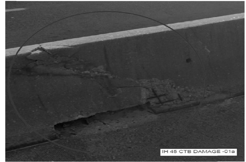
IH 45 CTB DAMAGES STA 360+58
