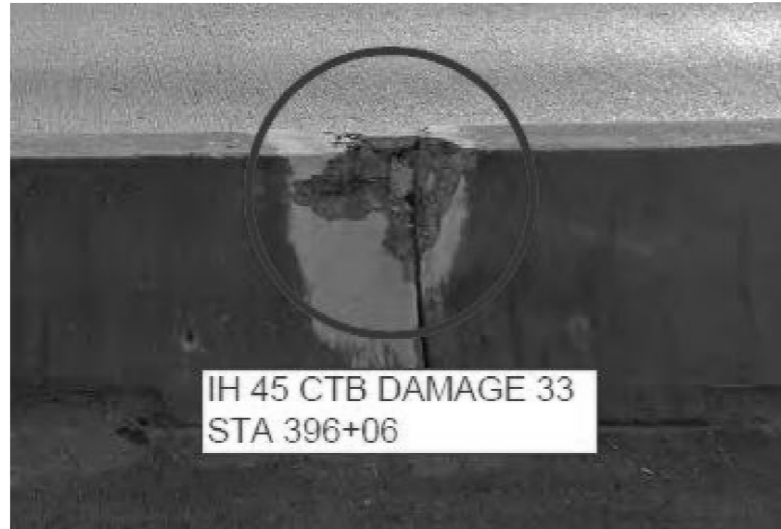
IH 45 CTB DAMAGES STA 396+06
