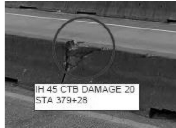
IH 45 CTB DAMAGES STA 379+28
