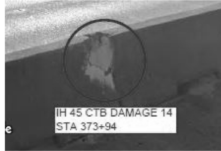
IH 45 CTB DAMAGES STA 373+94
