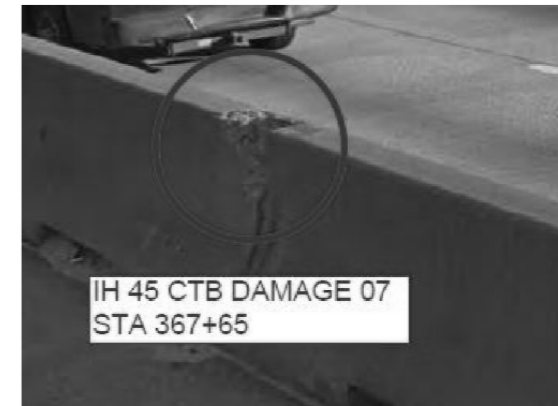
IH 45 CTB DAMAGES STA 367+65
