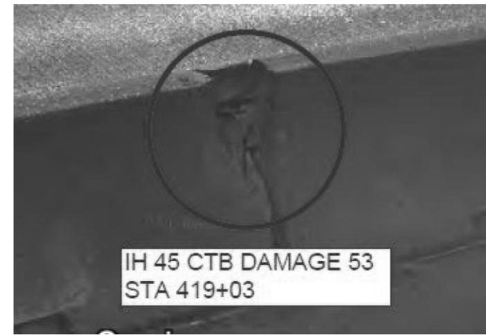
IH 45 CTB DAMAGES STA 419+03
