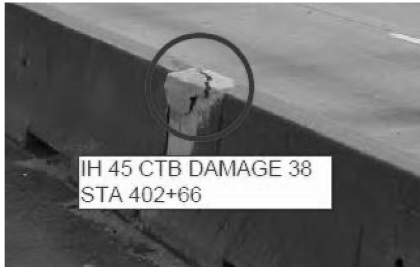
IH 45 CTB DAMAGES STA 402+66
