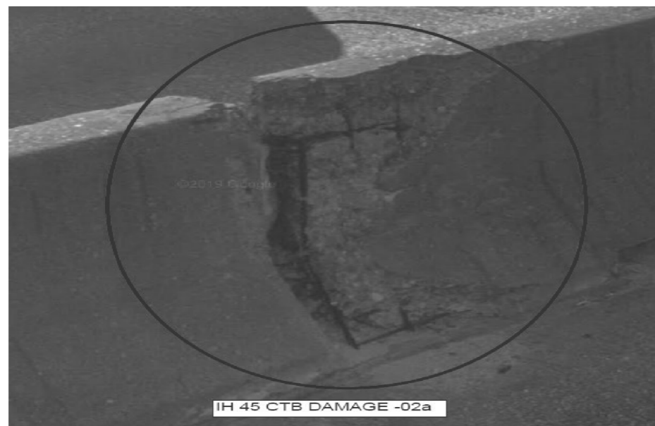
IH 45 CTB DAMAGES STA 347+93
