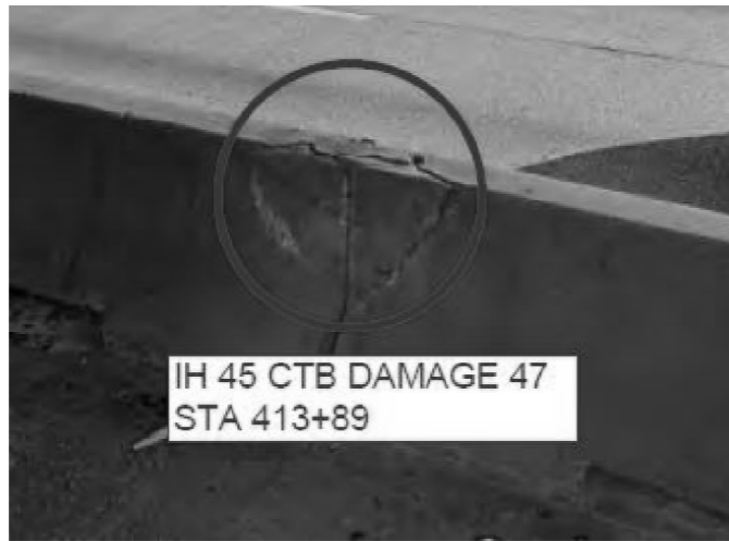
IH 45 CTB DAMAGES STA 413+89
