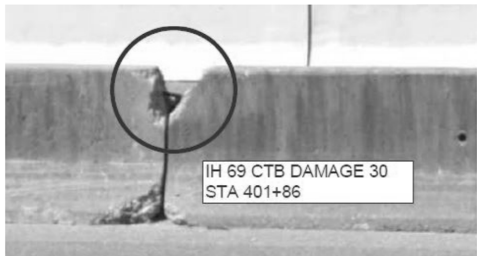
IH 69 CTB DAMAGES STA 401+86
