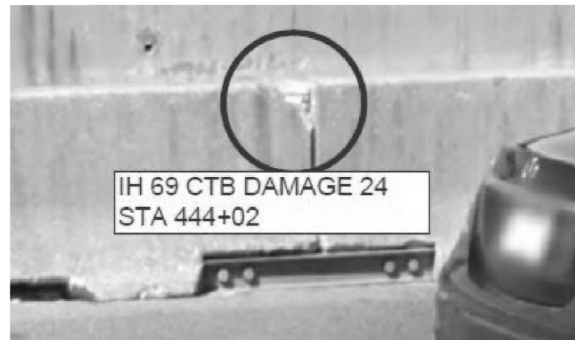
IH 69 CTB DAMAGES STA 444+02
