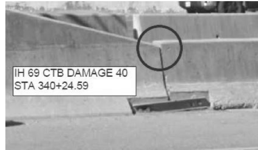
IH 69 CTB DAMAGES STA 340+24.59
