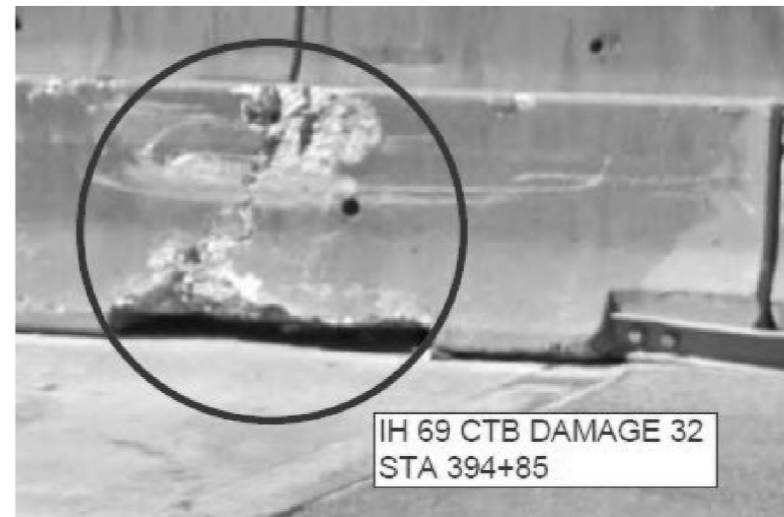
IH 69 CTB DAMAGES STA 394+85
